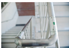
点字付手摺り
